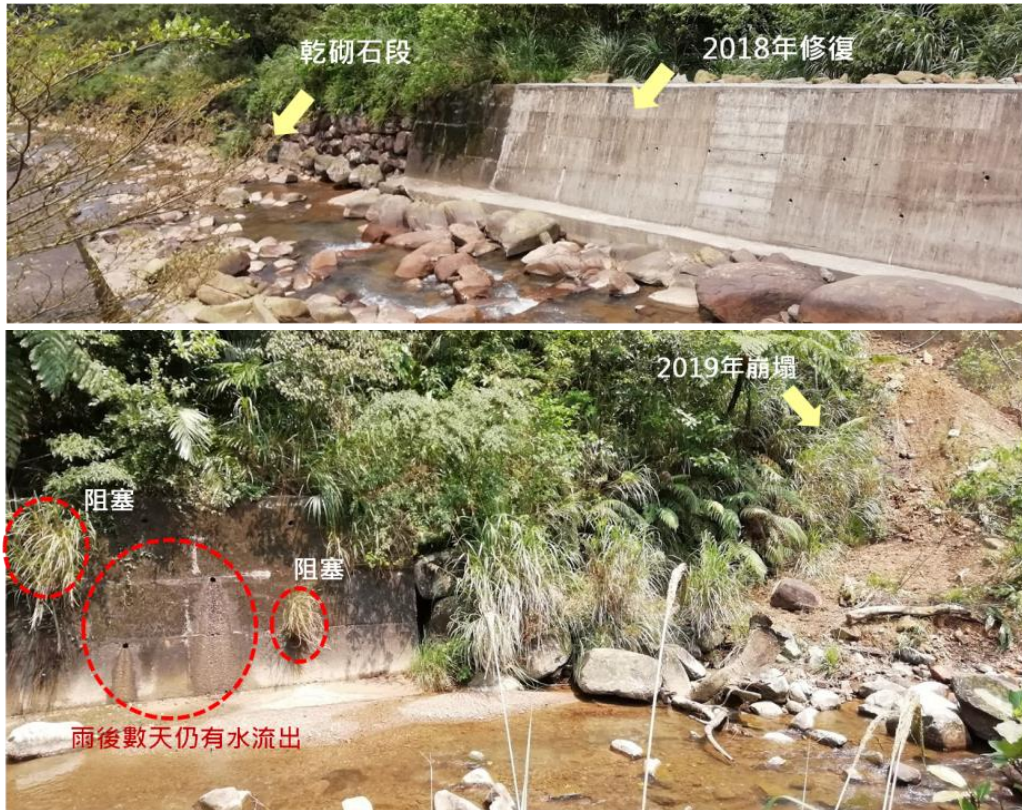
圖 13 混凝土護岸排水不良易導致山壁局部崩塌
