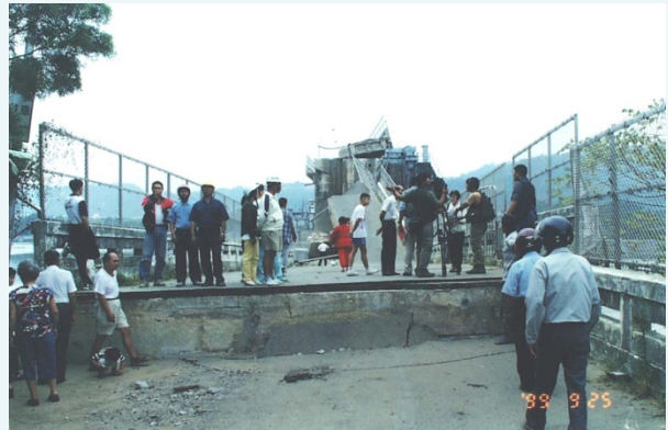
圖 1-7 九二一地震石岡壩壩右側垂直隆起 7m 破壞
