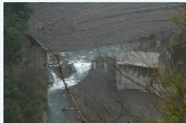
石門水庫集水區巴陵防砂壩損壞
