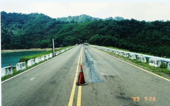
圖 1-5 九二一地震水社壩壩頂平行裂縫
