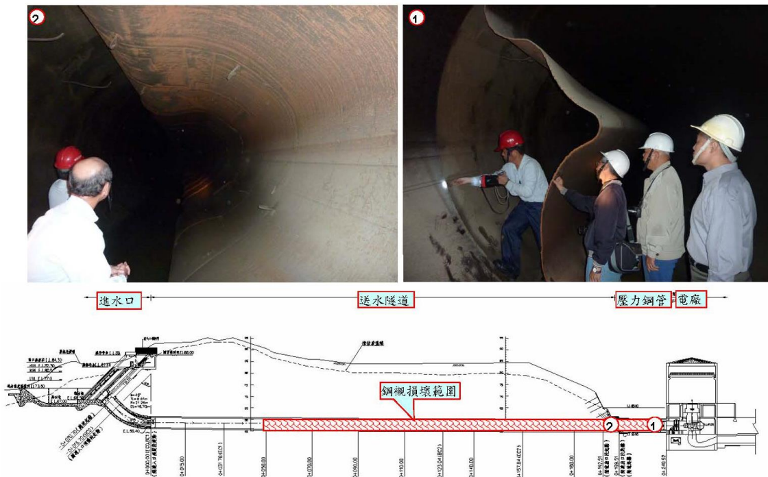
圖 13 西口電廠送水隧道損壞情形及延伸範圍圖
