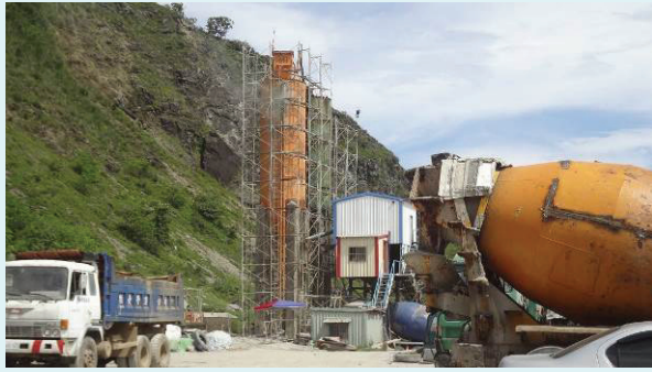
照片 17 現有預拌混凝土場停工斷料
