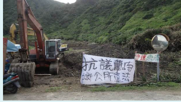
照片 18 申請新設預拌混凝土場遭受當地住民抗議無法設置
