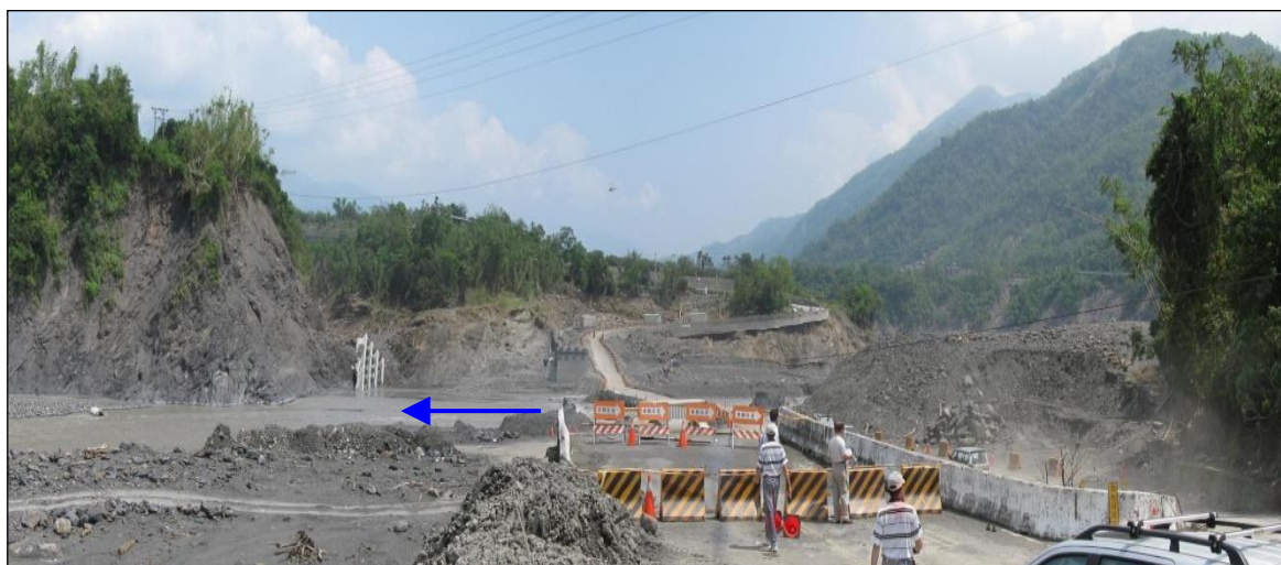
照片 5 由荖濃溪左岸望荖濃溪右岸邊坡崩塌
