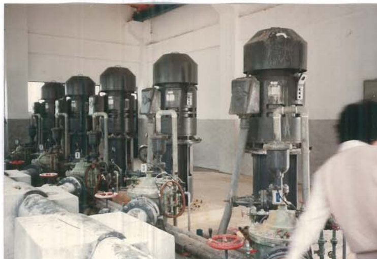
加壓站抽水設備現況
