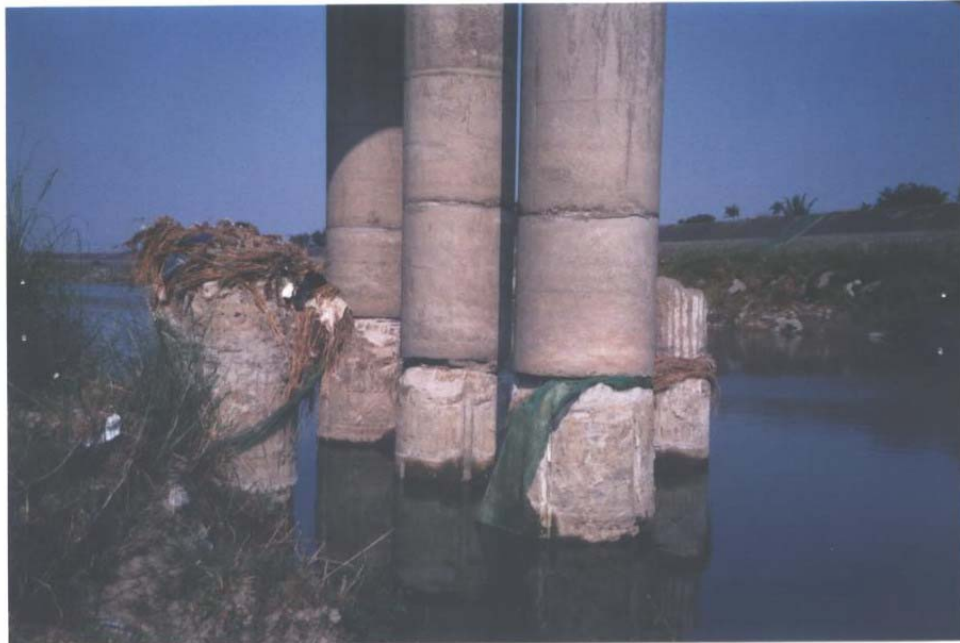
地點： 八掌溪洪水港大橋 內容記要： 第 17 號橋墩基樁破損情況
