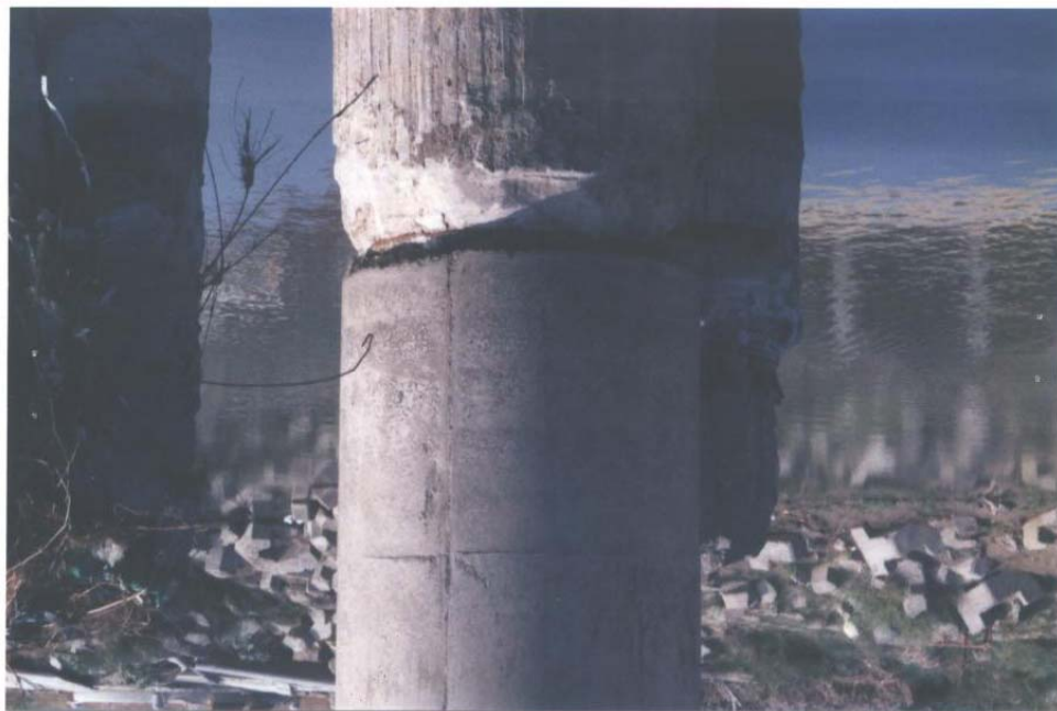
地點： 八掌溪洪水港大橋 內容記要： 第 17 號橋墩基樁破損鋼筋裸露銹蝕
