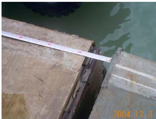
照片 2-2 104 碼頭伸縮縫開裂圖 E
