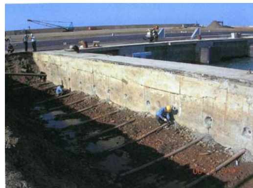
照片 2-3 前端之 72mm \Phi 拉桿斷裂脫離
