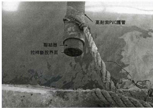
照片3-2 第82號上層拉桿斷脫照片(一)
