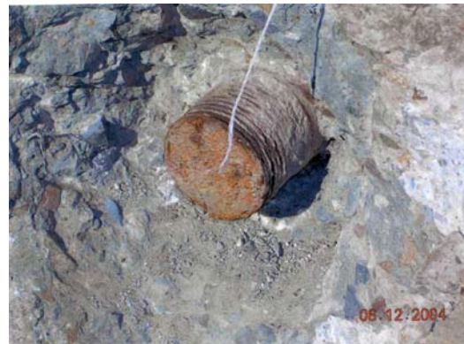
照片 2-4 前端之 72mm \Phi 拉桿斷裂脫離
