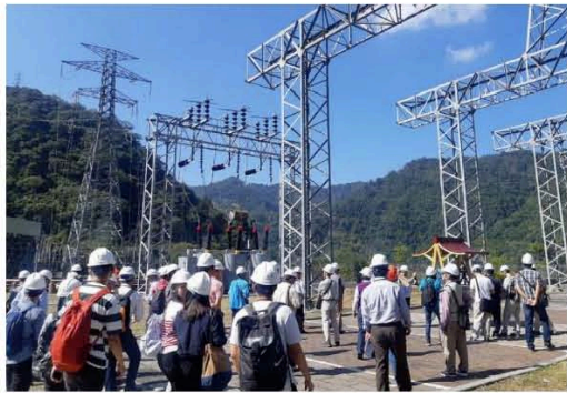
參訪天輪分廠電力公園與機組
