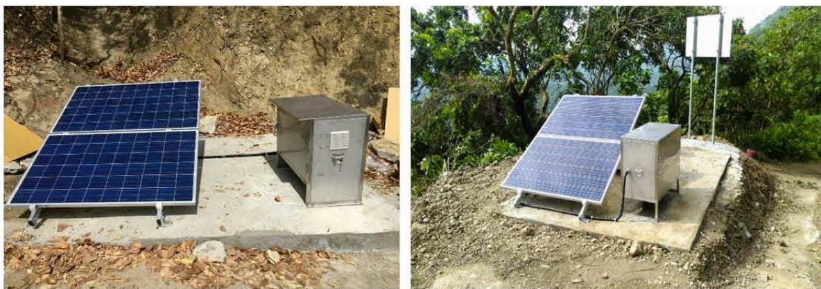
圖15 新烏山嶺隧道太陽能自動洩氣井系統
