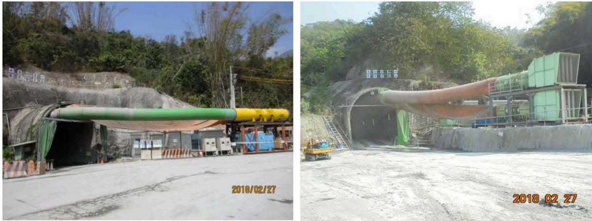
圖13 隧道通風設備
